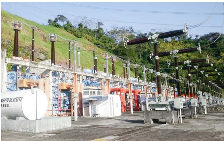
Malpaso main transformers
